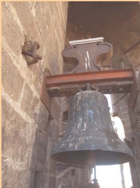
Campana Vicenta, condemnada per la intervenció de 1989-1991
